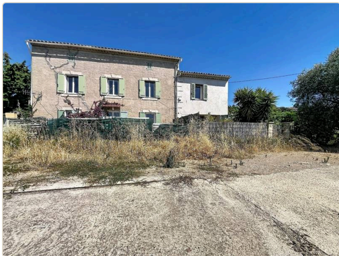
Бастида как она есть: трещины видны на фасаде
