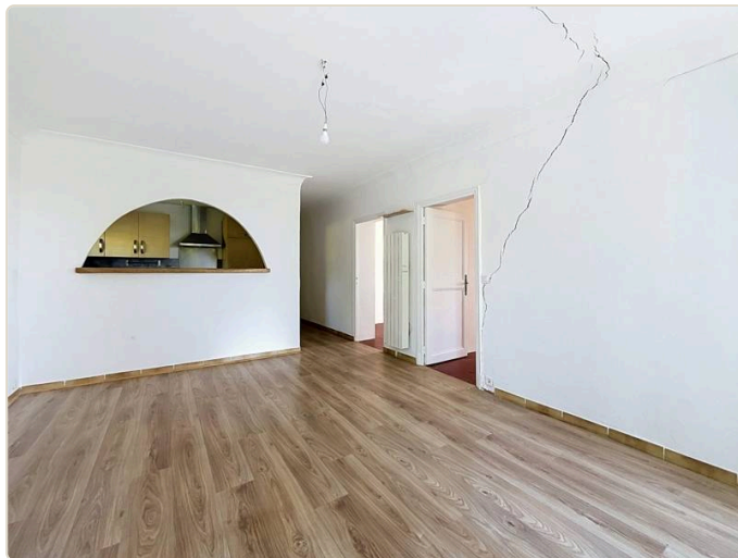
Салон: трещина по стене
