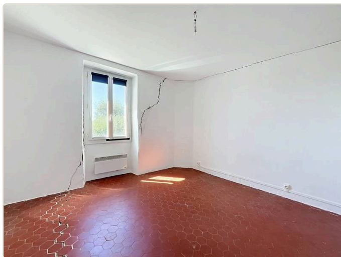
Спальня: пол-tomettes и трещина
